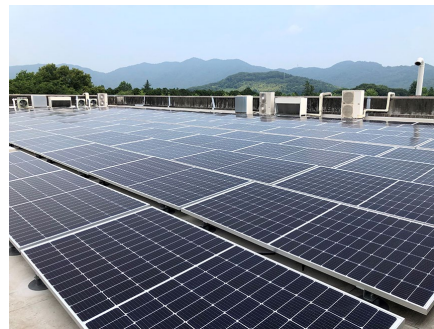
栃木事業所に導入した太陽光発電システム
