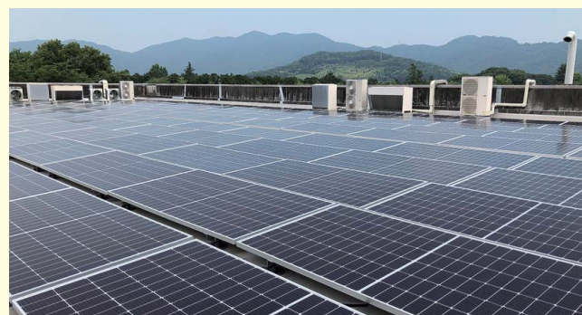
栃木事業所の開発建屋の屋上に設置した太陽光パネル *3
