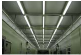
層流型クリーンルーム設備
